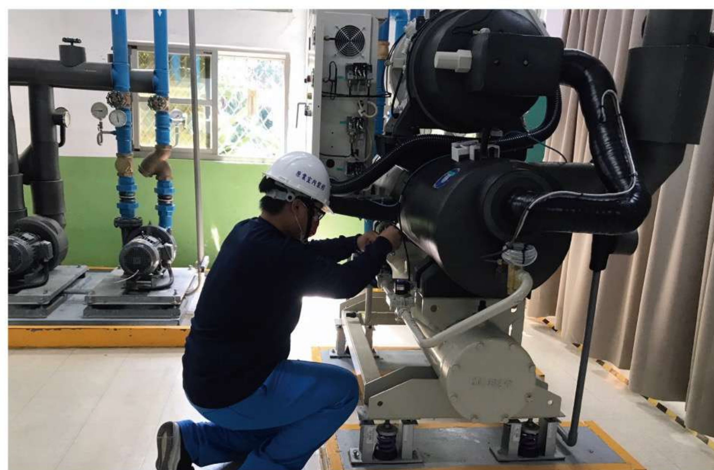
圖2 中央空調主機試俾調整
