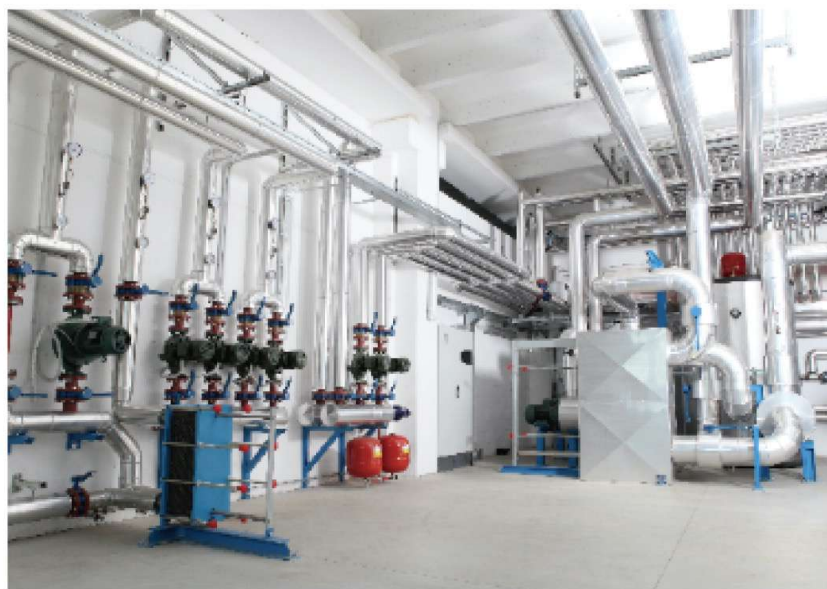
圖4 空調節能——無塵室工程
